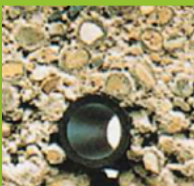
Jastrych cementowy Element ogrzewania podłogowego zatopiony w jastrychu cementowym
